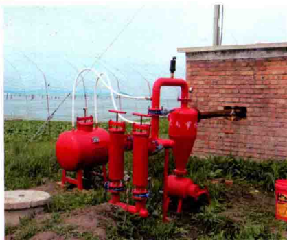
水肥一体化设施
