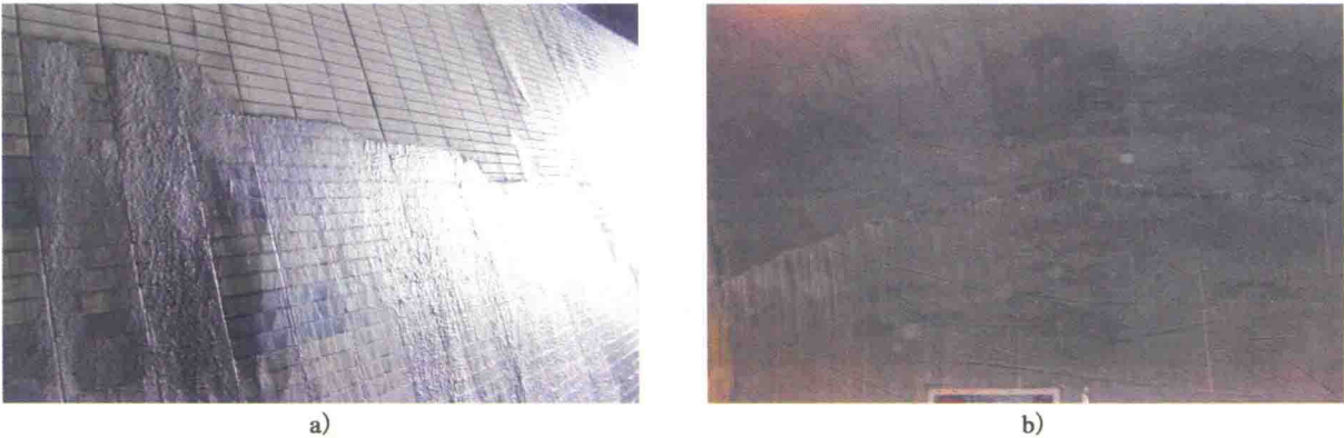
图 2.4-1 地下水过大导致衬砌开裂
