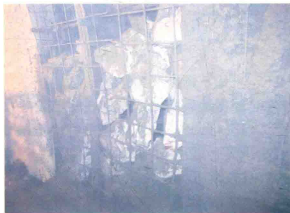
图 2.1-5 隧道初期支护回填不密实
