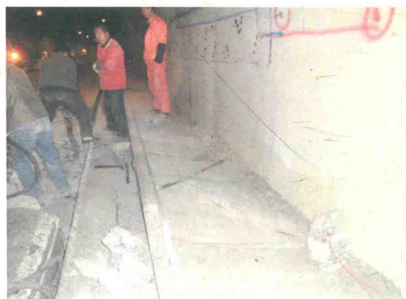
图 1.1-5 二次衬砌拱脚下沉
