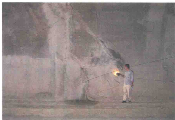
图 1.1-2 二次衬砌开裂
