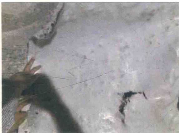
图 2.1-7 防水层被不平整喷射混凝土顶破、压裂
