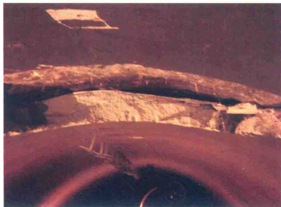
图 2.1-10 隧道衬砌拱部脱空
