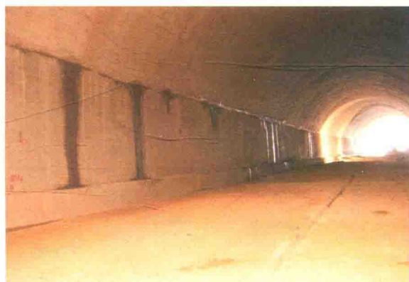
图 1.1-3 二次衬砌渗漏水
