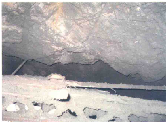
图 2.1-4 隧道初期支护背后空洞
