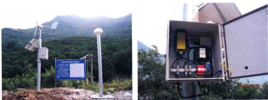
图 10 三峡白家包滑坡监测站点北斗终端系统
