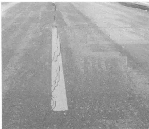
图 15 桥面铺装纵向裂缝图
