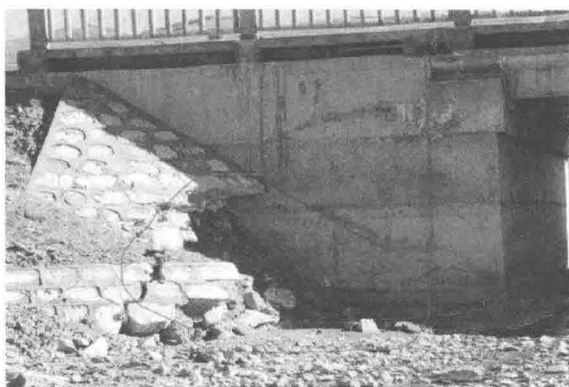
图4 锥坡冻胀破坏图
