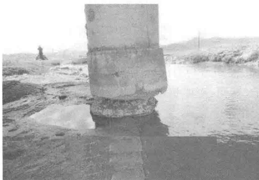
图9 水流冲刷导致损毁图
