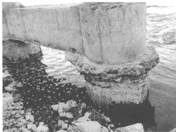
图 13 桥梁墩台桩头外漏图
