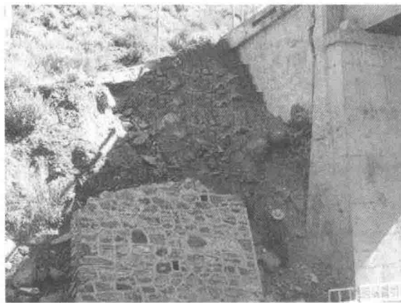
图 14 桥梁墩台护坡损毁图
