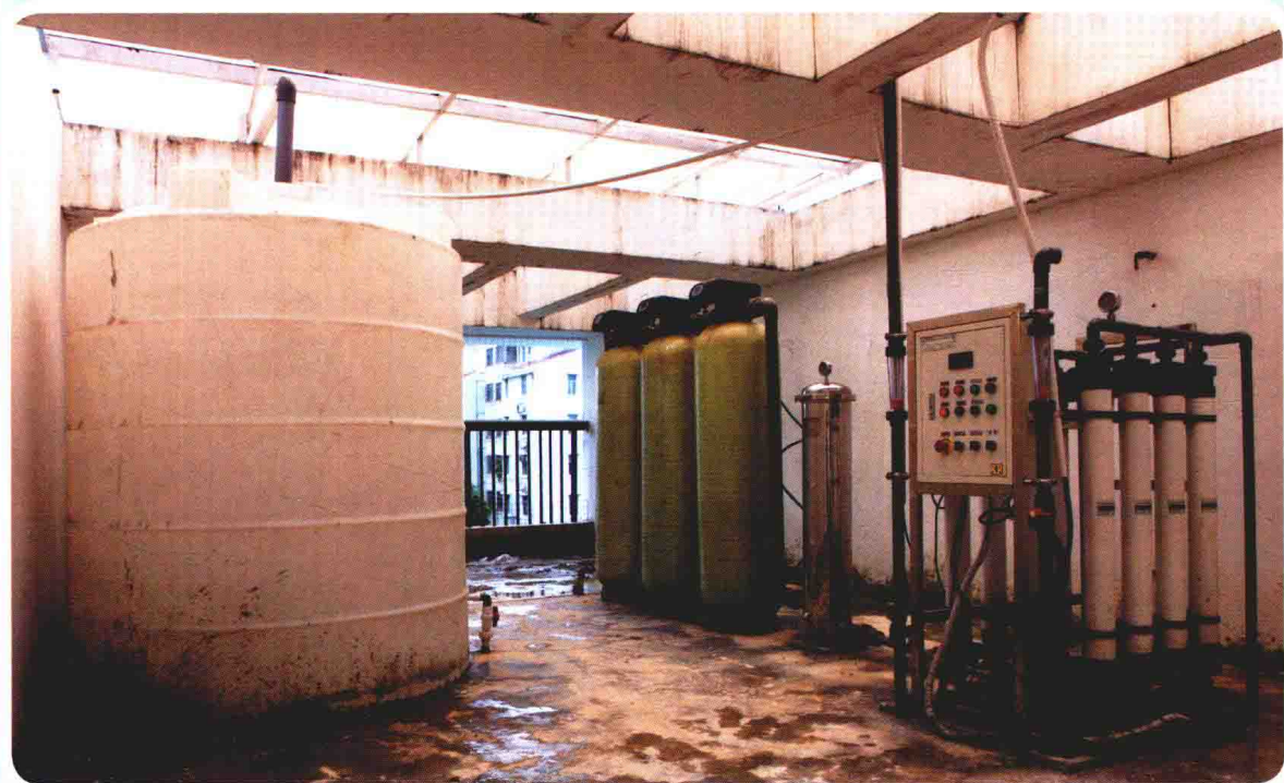
水处理循环过滤系统全景
