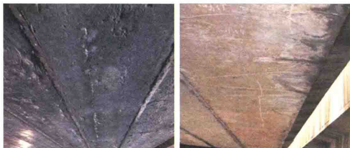
图 2-4 空心板板底纵向裂缝
