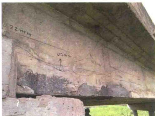
图 2-5 空心板腹板斜向裂缝
