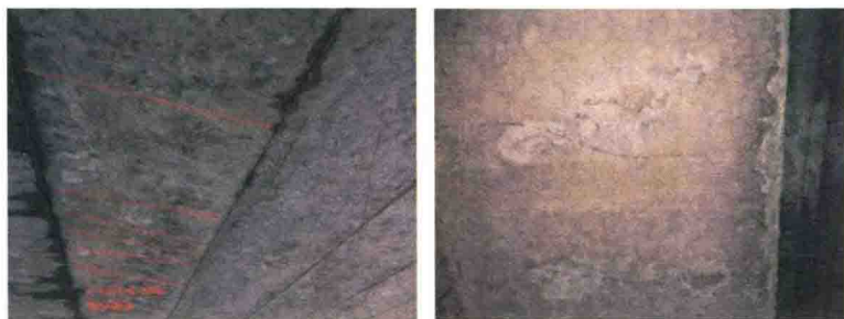
图 2-2 板底受拉区的弯曲裂缝
