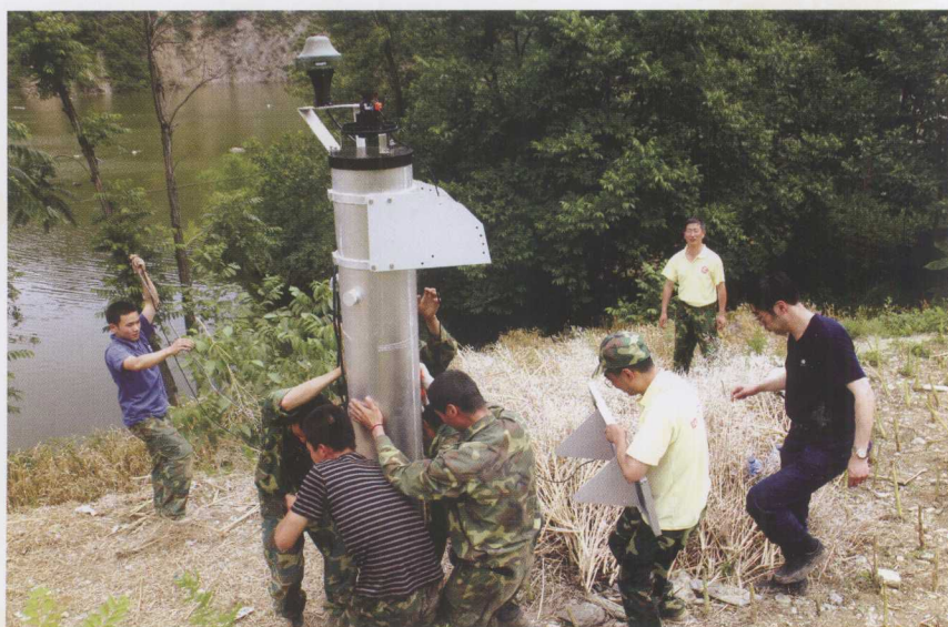
2008年5月30日，突击队员在唐家山上游禹里乡建设治城水位雨量自动监测站
