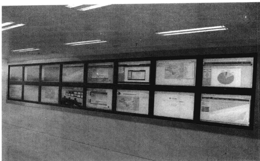
图 1.10 监控室显示系统
