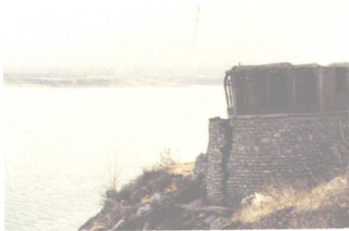
(f) 河流、湖泊、池塘岸边、房屋易滑塌
