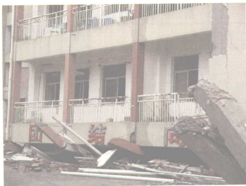
(d) 地基失效、房屋倾斜、构造柱连接部位脆性破坏
