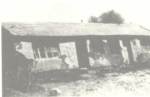
(e) 软弱、软硬不均匀土层地震时地基沉陷、房屋倾斜倒塌
