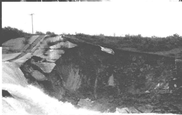
2007年白露河生产圩堤上堤路水毁情况
