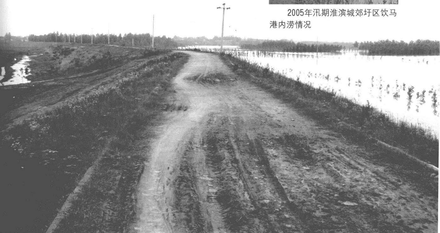
2005年汛期淮滨城郊圩区宋营段外洪内涝情景
