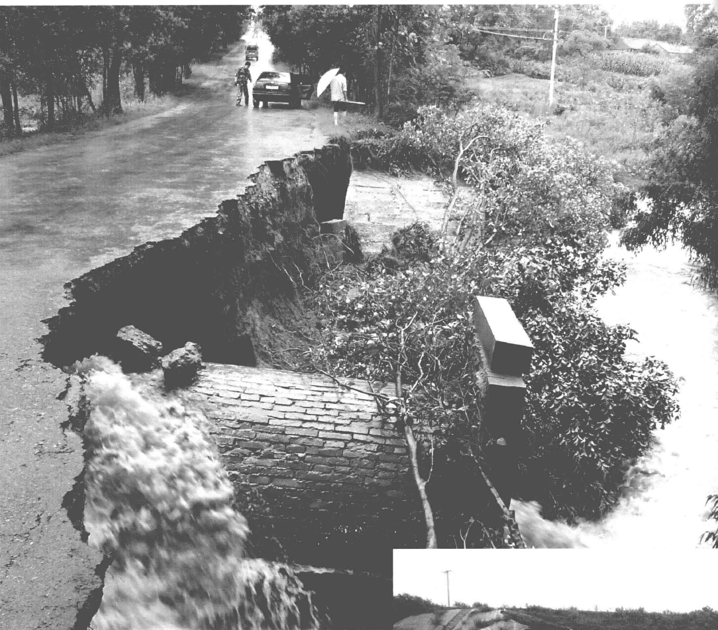
2005年汛期淮滨城郊圩区宋营段外洪内涝情景
