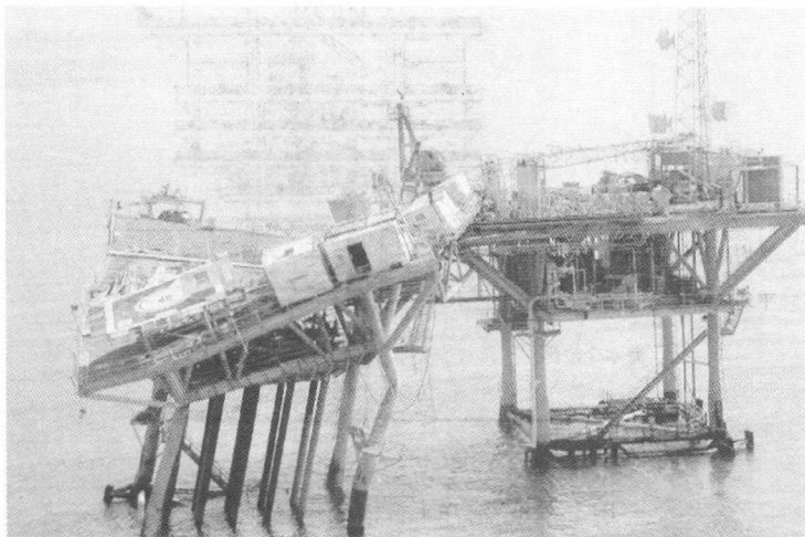
图 1-17 被飓风吹倒的平台
