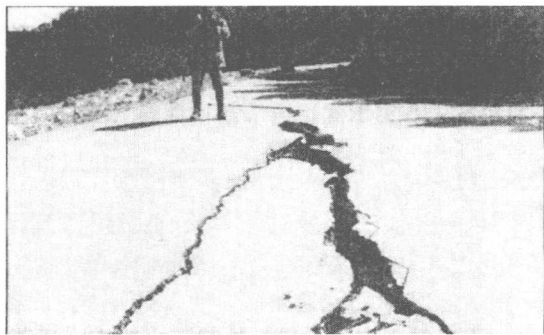
图 1-5 丽江地震中柏油路面震裂
