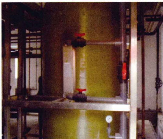
图 2-17 除盐水换热器未设计加热管线
