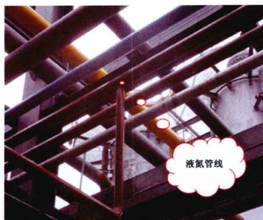
图 2-13 液氮管线和 PSA 制氮管线连接错误
