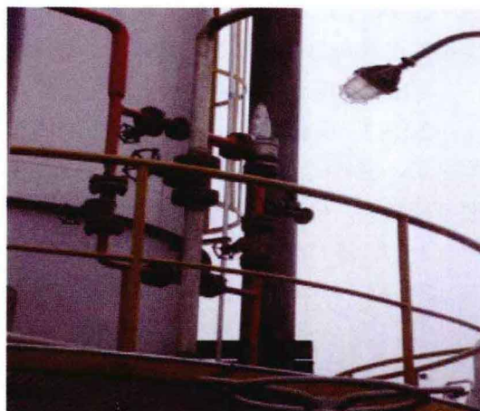
图 2-16 整改后的净化风管线
