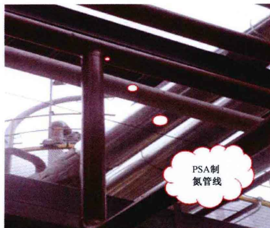
图 2-14 整改后的氮气连接管线
