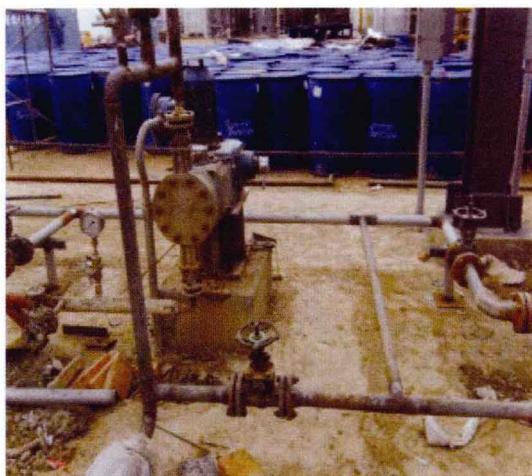
图 2-6 泵出口新增的旁通管线
