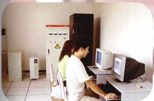
拥有一流设施的现代化中控机房
