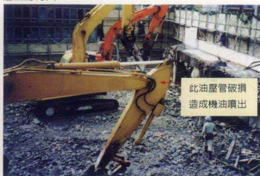
6 對欲拆除的建築物正進行拆除作業之際，由於拆除機具的油壓管脫落導致機油噴出並散落於工地外的行人身上。
