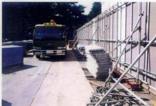
6 上圖右側模板的堆積雖然底部設有墊物，但堆置不整齊。也是一種會造成危險的堆置方式。
