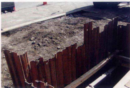
1 電力人孔的開挖作業在臨接道路面毫無設置防止墜落的扶手等措施，最容易造成小孩墜落的故事。
