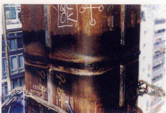
4 組立鋼骨柱用的臨時接合板在進行切除時。因切除作業產生的火花由防護措施的間隙落下而打到走在人行道上的行人。
