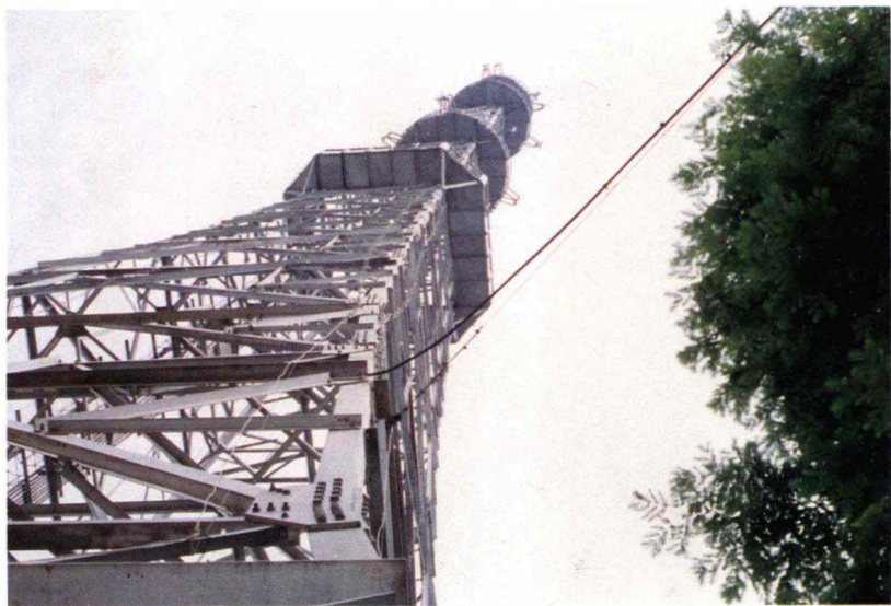
邮电局移动通信(大哥大)铁塔
