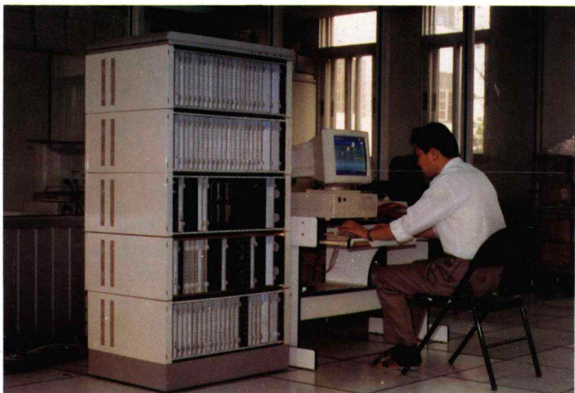
程控电话机房
