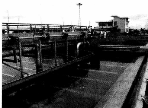
图1-1 污水处理实景图
