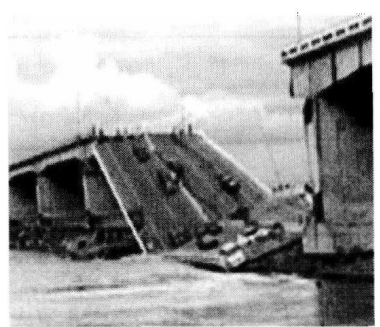
图 1-12 高屏大桥拦腰断裂
