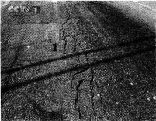
图 1-2 桥面铺装纵向裂缝
