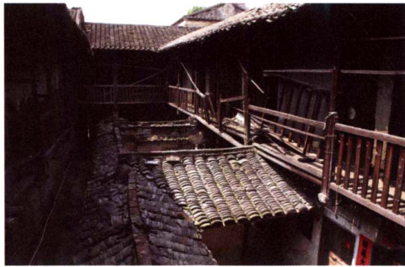
腐朽损坏的走马栅
