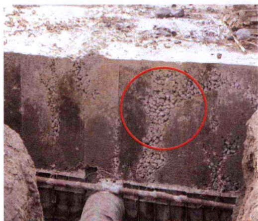
图 1-2-6 混凝土表面蜂窝
