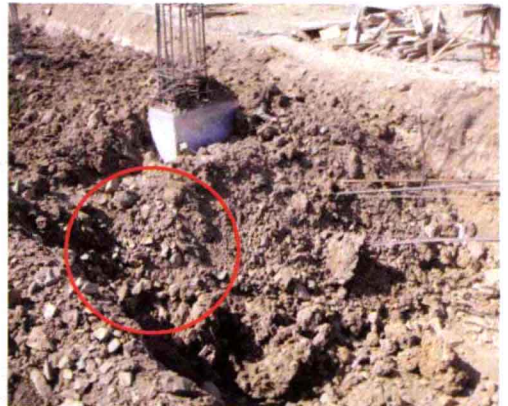
图 1-1-3 回填土未分层回填
