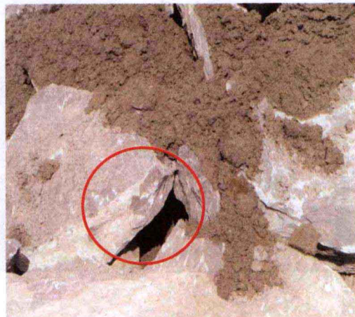
图 1-2-5 毛石砌筑砂浆不饱满,存在“孔洞”
