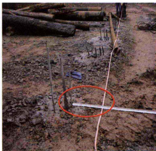
图 1-2-11 灌注桩桩位偏差超标
