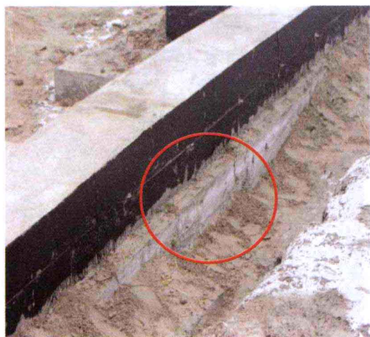
图 1-2-10 基础埋地部分未按设计要求防腐
