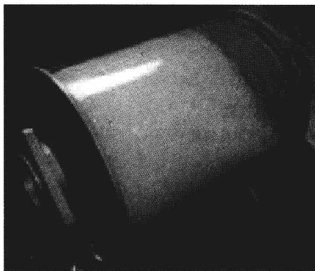
图 1-11 变压器的呼吸器
