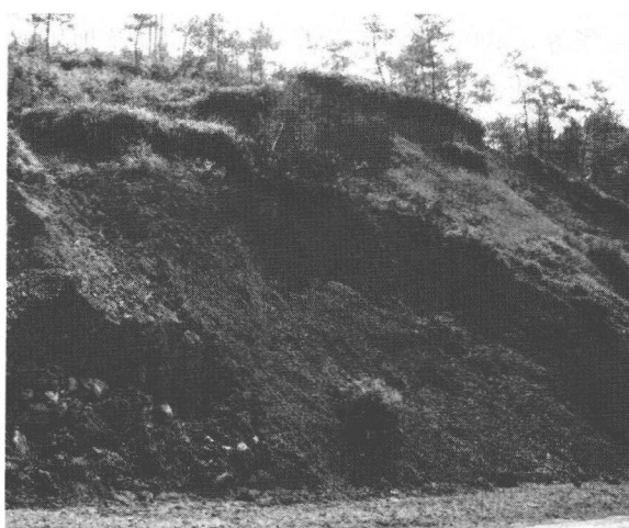
图 2.2 黏性土边坡坍塌
