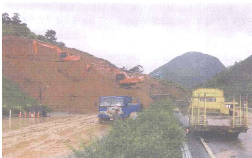
图 1-15 广西平钟高速公路山体滑坡
