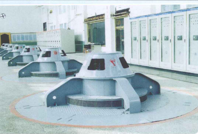
西湖泵站机组新貌
