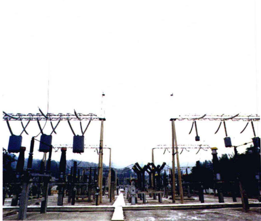
华中电网枢纽之一——舞钢小石门22万伏变电站
