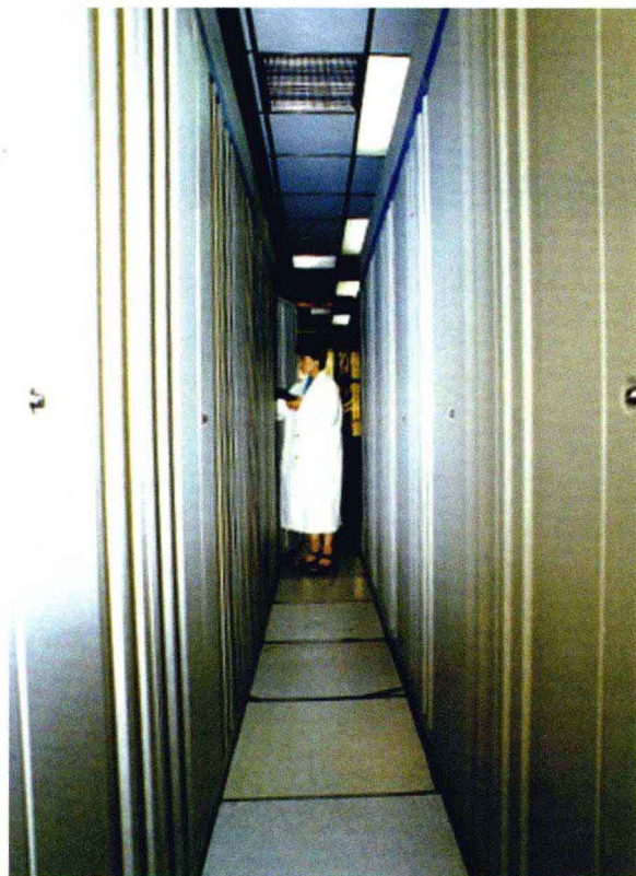
电信程控机房
