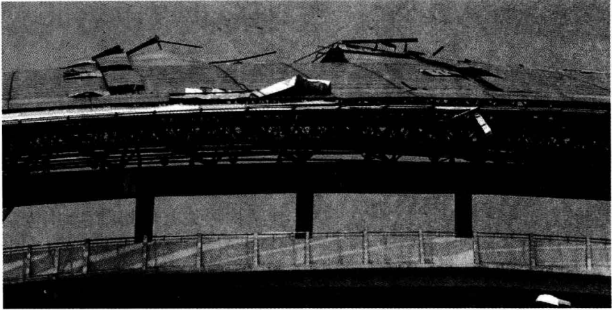
图 1-1 河南体育馆屋盖被风吹坏
