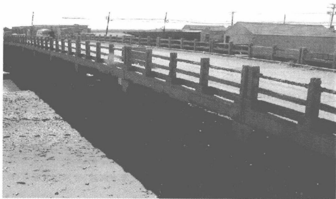
图 1-3-13 河北沧州滨海老桥(20 世纪 70 年代建成)盖梁和桥面边梁的腐蚀开裂、保护层脱落、露筋,桥梁已成危桥 (高冬光,2010 年 11 月)
