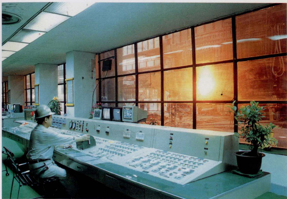
重庆钢铁股份有限公司转炉主控室。
