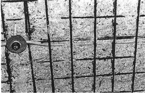
(2)腐蝕構造：海域環境鋼易侵蝕
