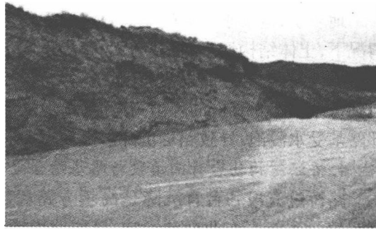
图 2-4 路堤排水系统不畅通
