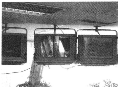
图 1.7 中央控制室的工业电视近景图
