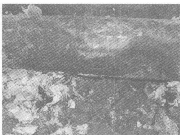
图 1.1-11 某管道外防腐层充水，剥离管体腐蚀严重
