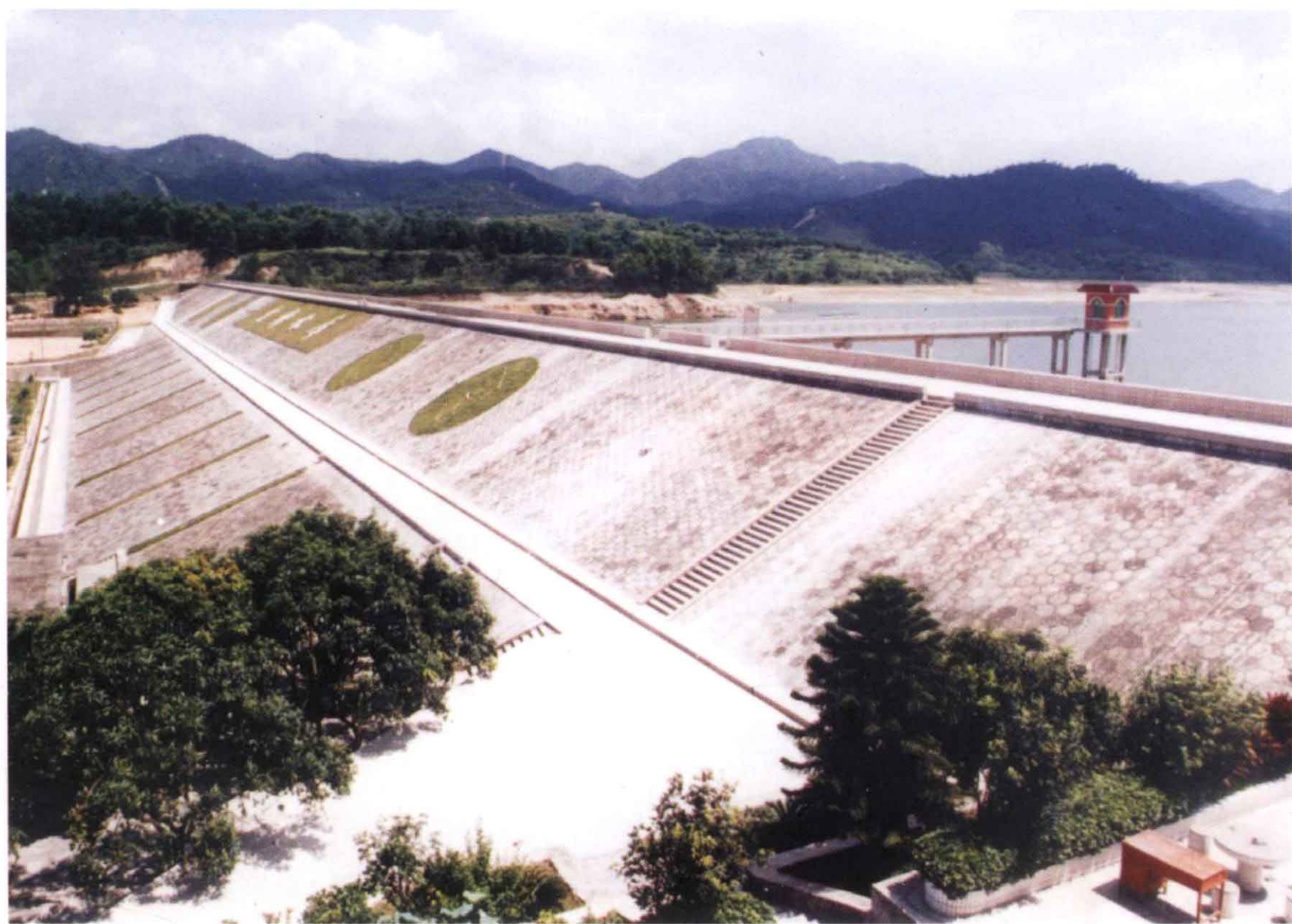
加固后的金钟水库，大坝具有自动安全监测功能。
