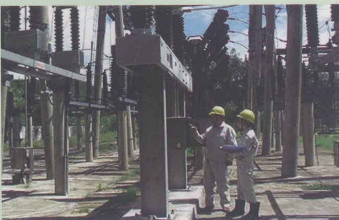
南澳金牛110千伏变电站
