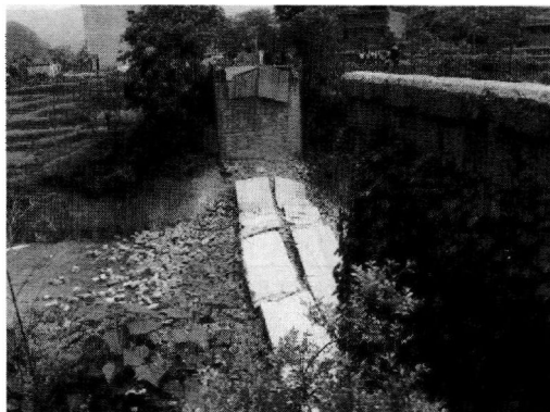
图 1-6 湖南娄底白马溢洪石拱桥 (2006 年 4 月 29 日坍塌)
