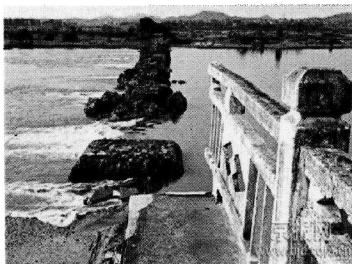
图1-9 江西上饶傍罗石拱桥 (2007年5月9日坍塌)
