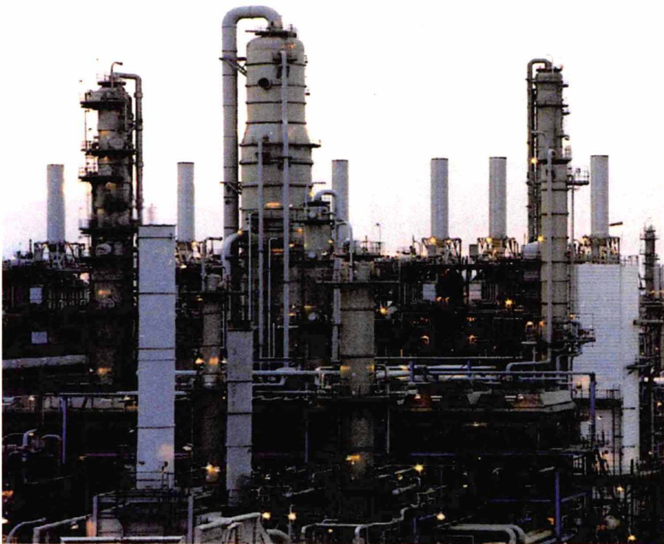
图 1-14 石油化工生产设备
