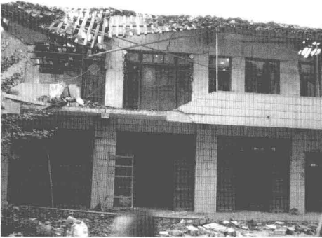
图 1.3 震损的砖木结构房屋
