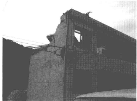
图 1.4 震损的砖混结构房屋
