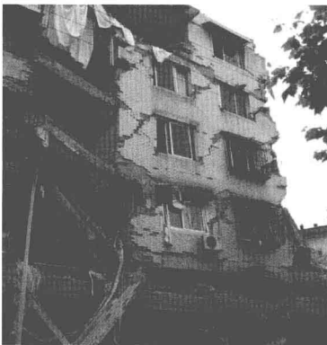
图 1.5 震损的底部框架—上部砖混结构房屋
