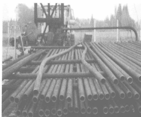
图 1.7 某盐穴储气库造腔内管弯曲
