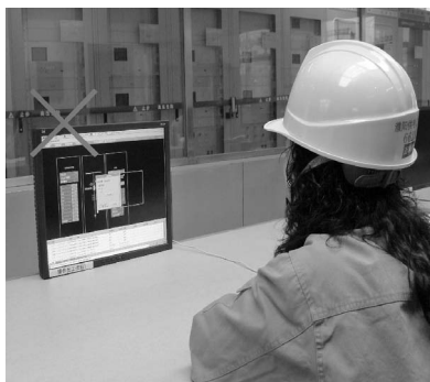
图 2-11 不允许单人通过“五防”进行遥控操作
