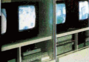
生产调度监视(控)系统
