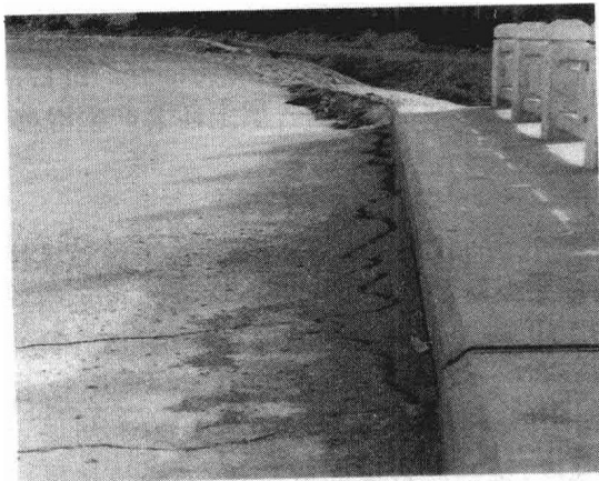
图 1.13 桥台附近填土开裂(丽江地震,1996)
