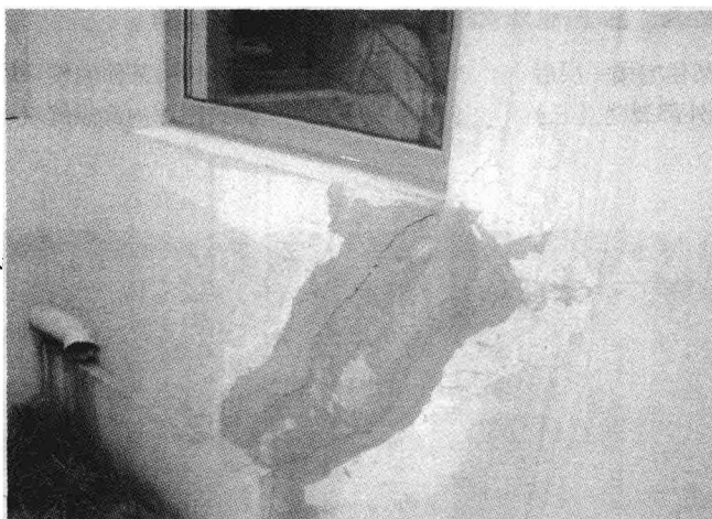
图 1-8 某住宅楼一层后砌筑门厅外部裂缝（二）
