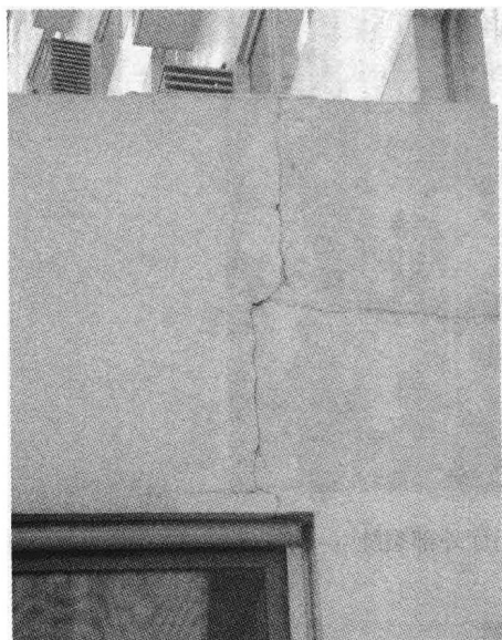
图 1-9 某住宅楼一层后 砌筑门厅外部裂缝 (三)
