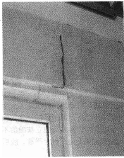
图 1-12 某住宅楼一层后 砌筑门厅内部裂缝 (三)
