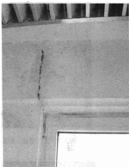
图 1-10 某住宅楼一层后 砌筑门厅内部裂缝 (一)
