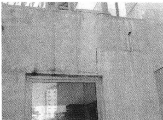
图 1-7 某住宅楼一层后砌筑门厅外部裂缝（一）
