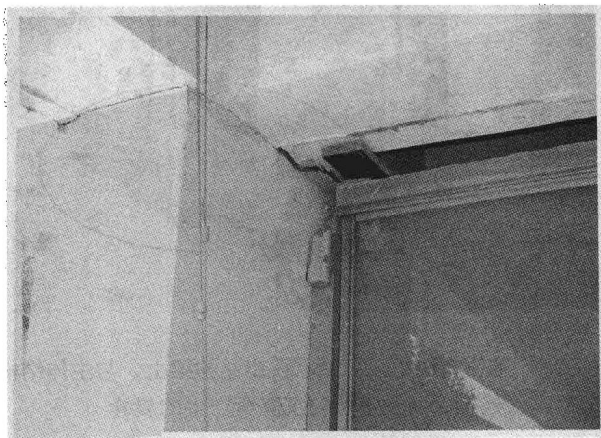
图 1-14 某住宅楼一层后砌筑墙体裂缝
