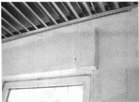
图 1-13 某住宅楼一层后砌筑门厅内部裂缝（四）
