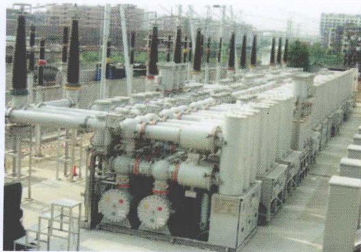
彩图 1-49 由 252 kV SF 6 气体绝缘 GIS 组成的 220 kV 变电站
