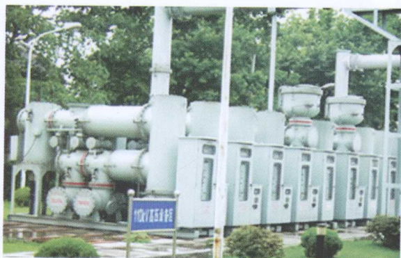
彩图 1-48 由 SF 6 气体绝缘的 GIS 组成的 110 kV 变电站
