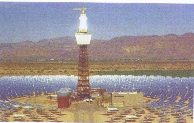
彩图 1-31 塔式太阳热发电厂外景
