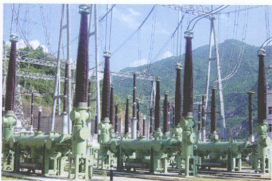
彩图 1-46 由 SF 6 气体绝缘罐式断路器组成的 500 kV 变电站
