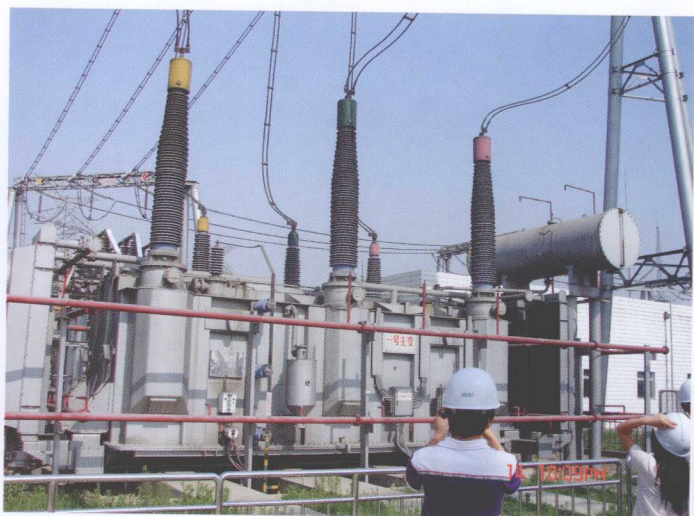
彩图 1-33 位于西安东郊的 330 kV 枢纽变电站中的巨型电力变压器 (240 MVA)
