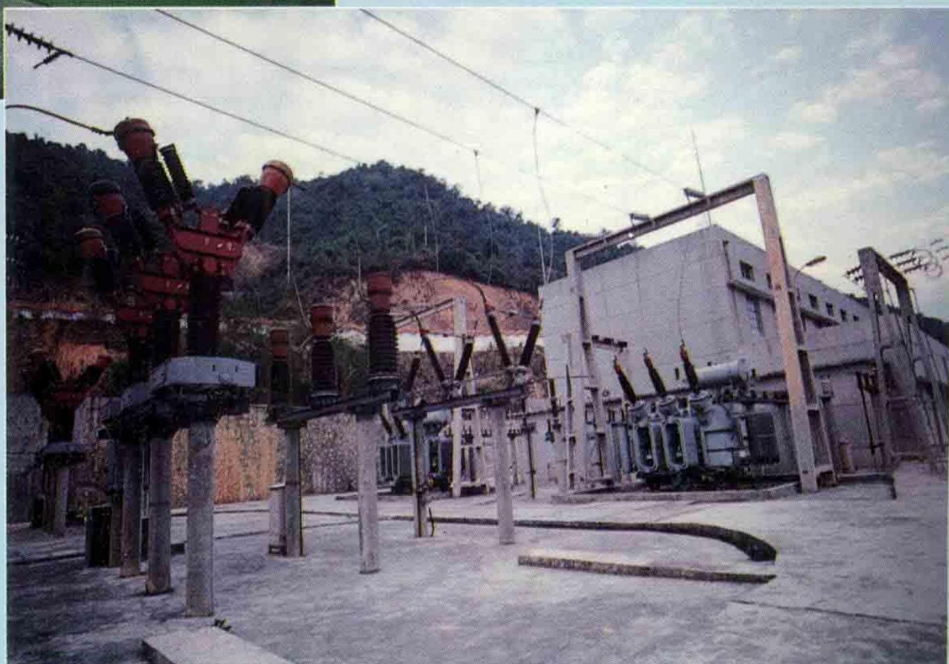
△户外升压站。 胡耀钧摄
