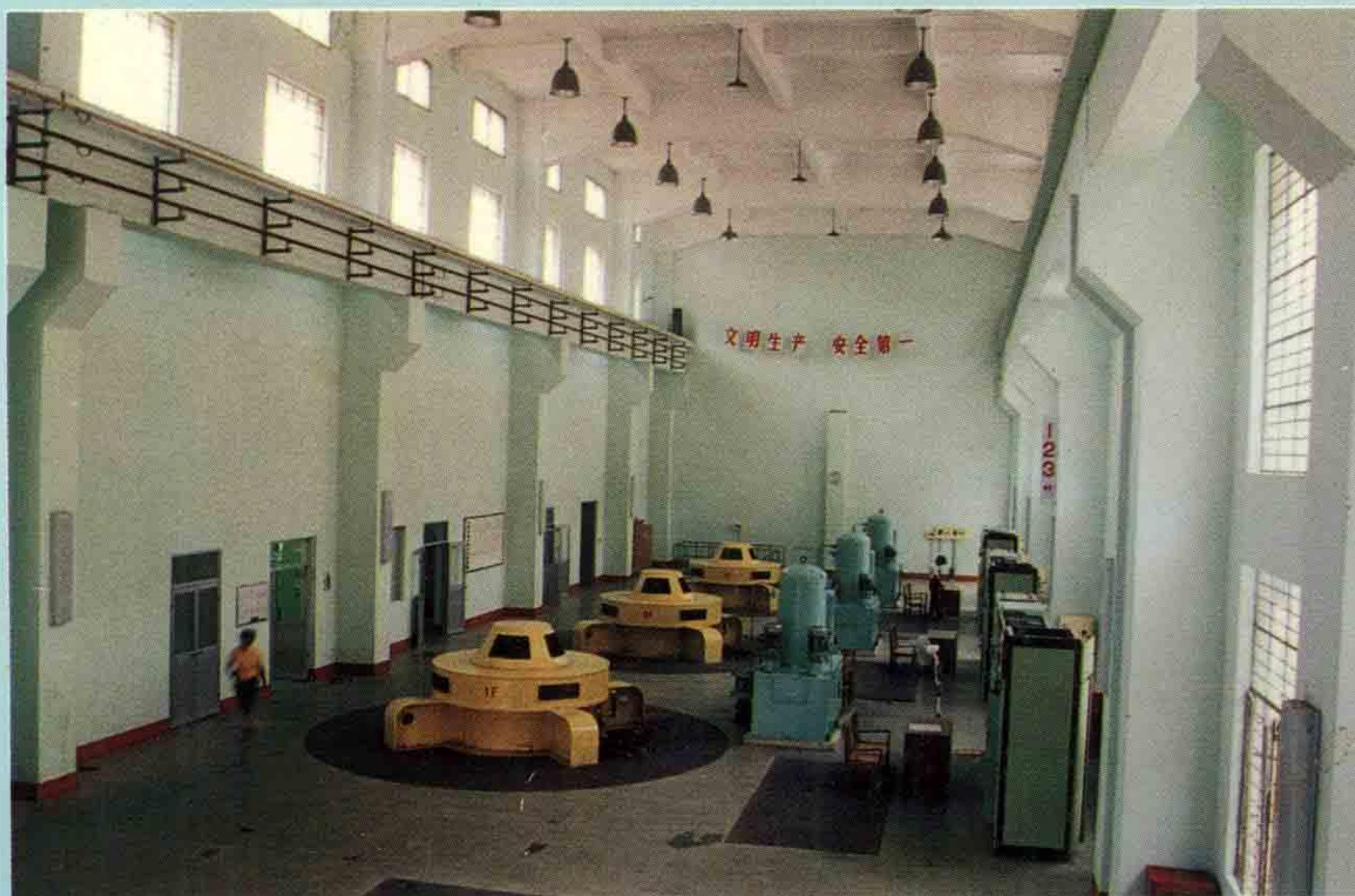
△水电站发电机层。 胡耀钧摄
