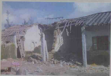
▲ 陆丰市受 9509 号台风袭击倒塌 住房实况(汕尾市民政局社教科供稿)
