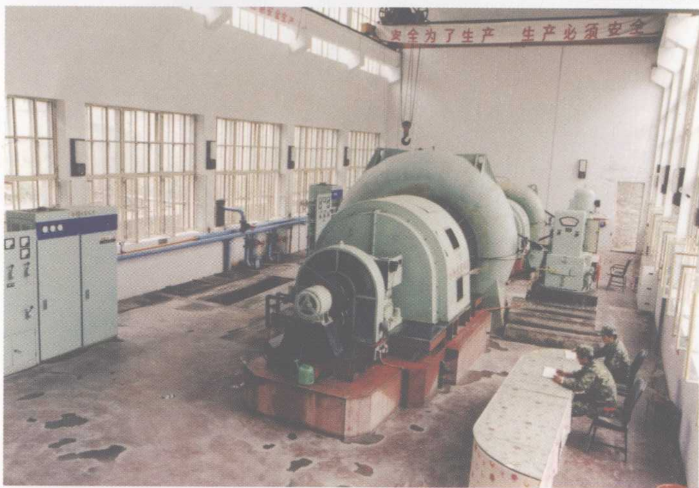
水电站机房 (辛建平 摄)
