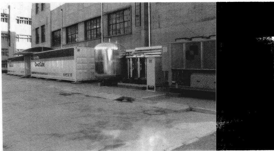
世纪互联的集装箱数据中心
