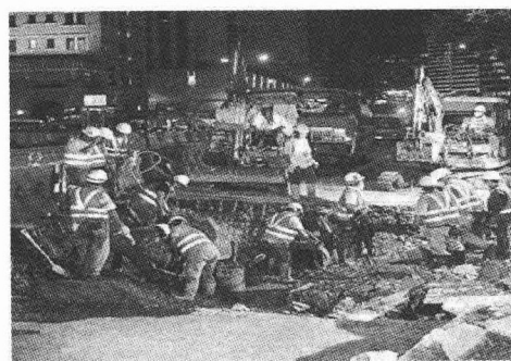
图 1.5 香港地铁施工引起路面沉陷
