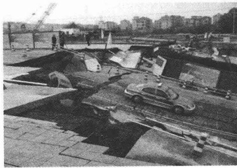
图 1.6 杭州地铁施工造成路面沉陷破坏
