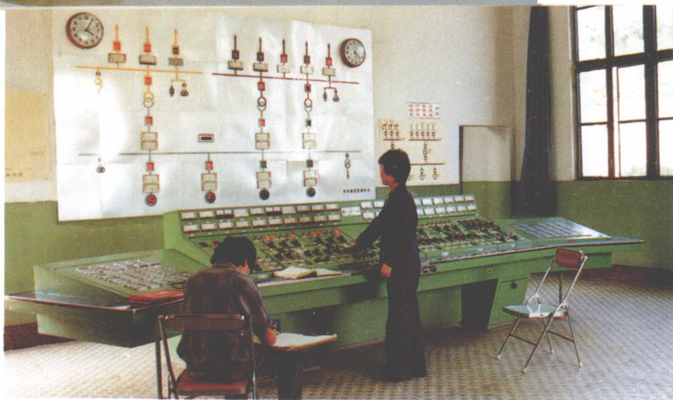
▶ 南阳滩水电站机房
