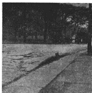
图 1-8 地面挤压鼓起
